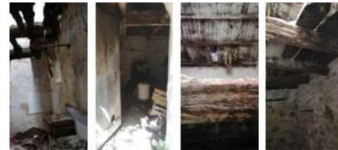
Degrado delle travi in legno
